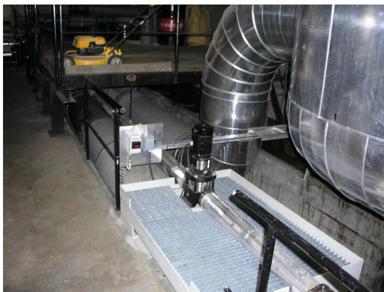
Ny pump för pumpning av fjärrvärmevatten genom växlare för oljeuppvärmning
