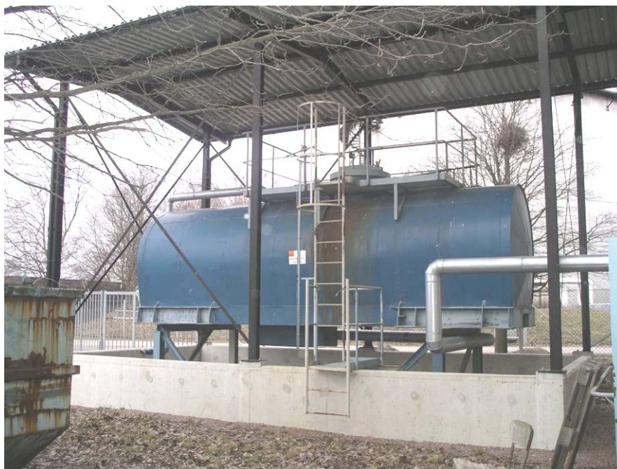
Luttank med invallning och nederbördsskydd
