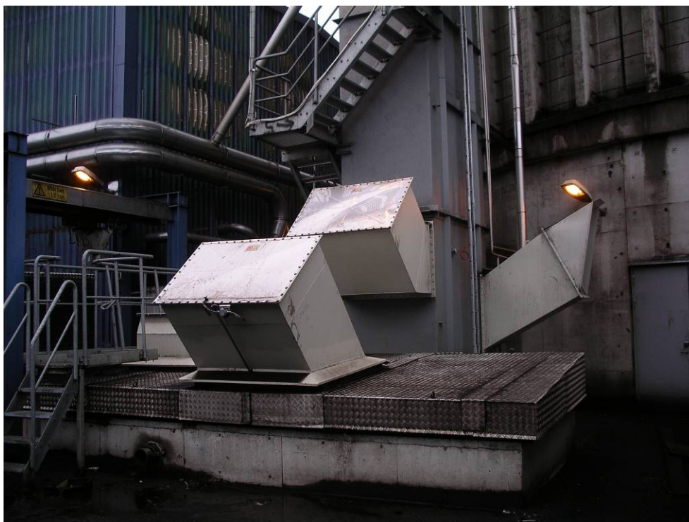
Explosionsavlastning före elevator till lagersilo 5, sk "Q-box"
