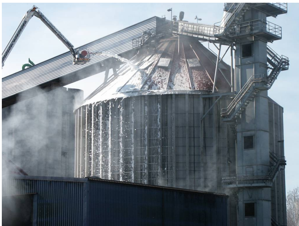
Fyllning av skum genom explosionsluckor lagersilo 4
