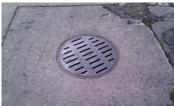
Figur 2 och 3: Flygplatta som avvattnades via det perforerade brunnsocket till spillvattennätet
