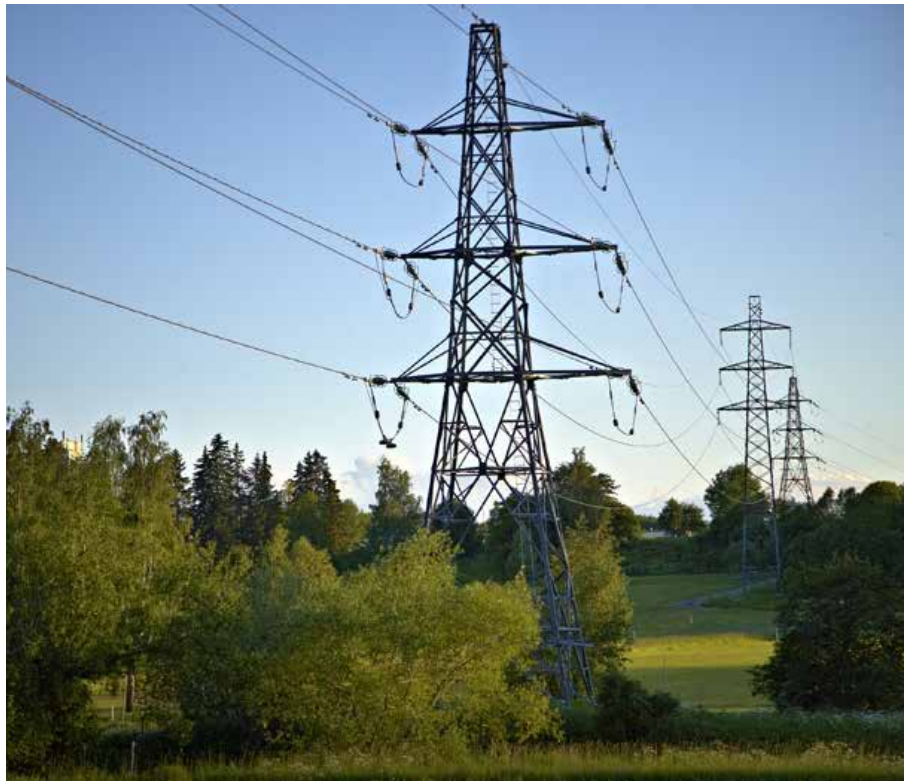
Svenska kraftnäts stamnät – som är sammankopplat med Vattenfalls regionnät, som i sin tur för över el till Mälarenergis lokala nät.
