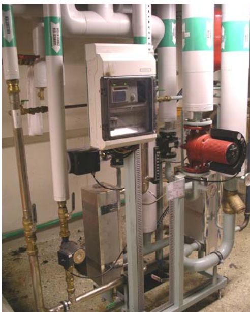
Inkoppling av fjärrvärme istället för spädvatten
