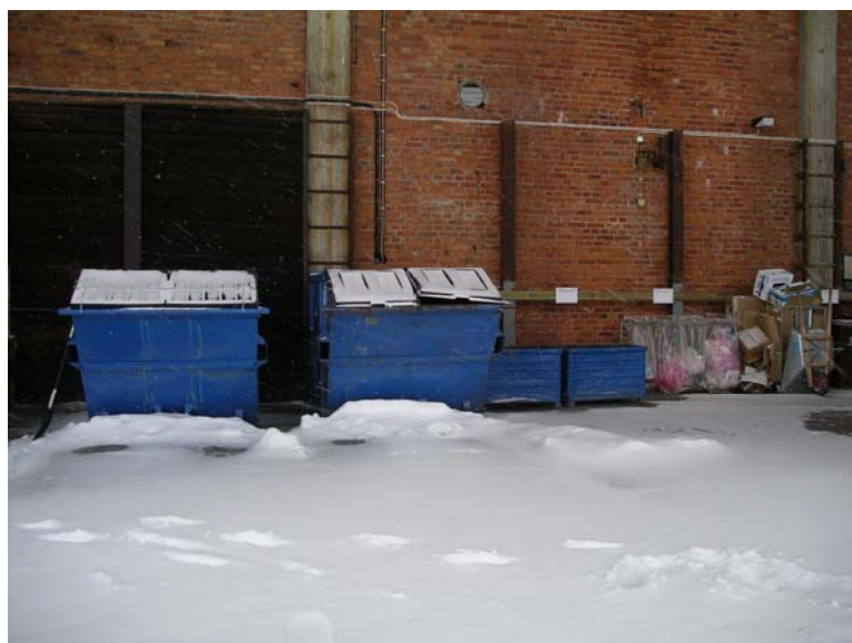
Station för källsortering. På bilden har snö blåst in under taket p g a kraftig vind.
