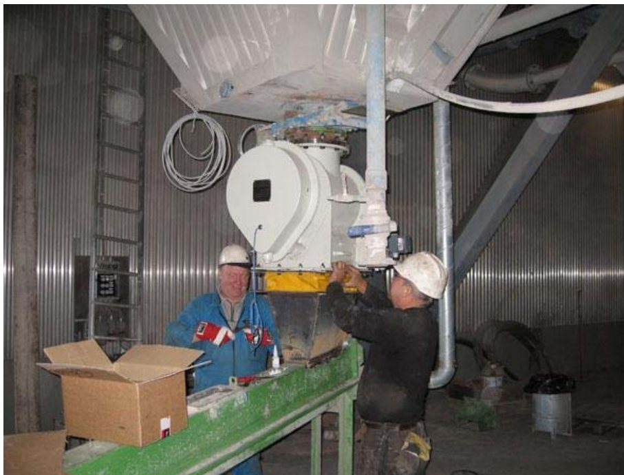
Montage av självrensade cellmatare, den gröna undre delen är en askränna
