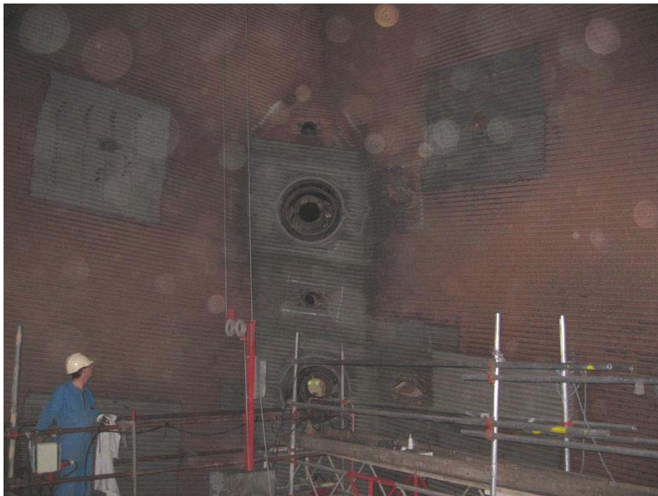
Arbete i Panna 4:s eldstad. Bilden visar två av de sexton brännarna i eldstaden (mitten)
