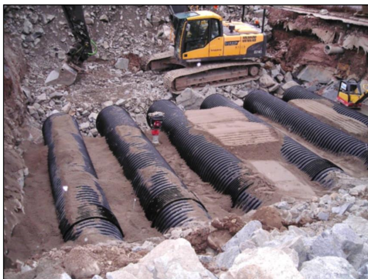
Figur 4: Fördröjningsmagasinet på Hemdal.
