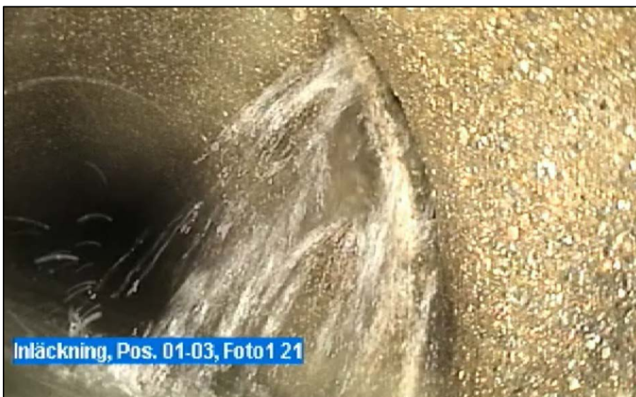
Figur 7: Inläckage av dagvatten vid Rocklundamotet.
