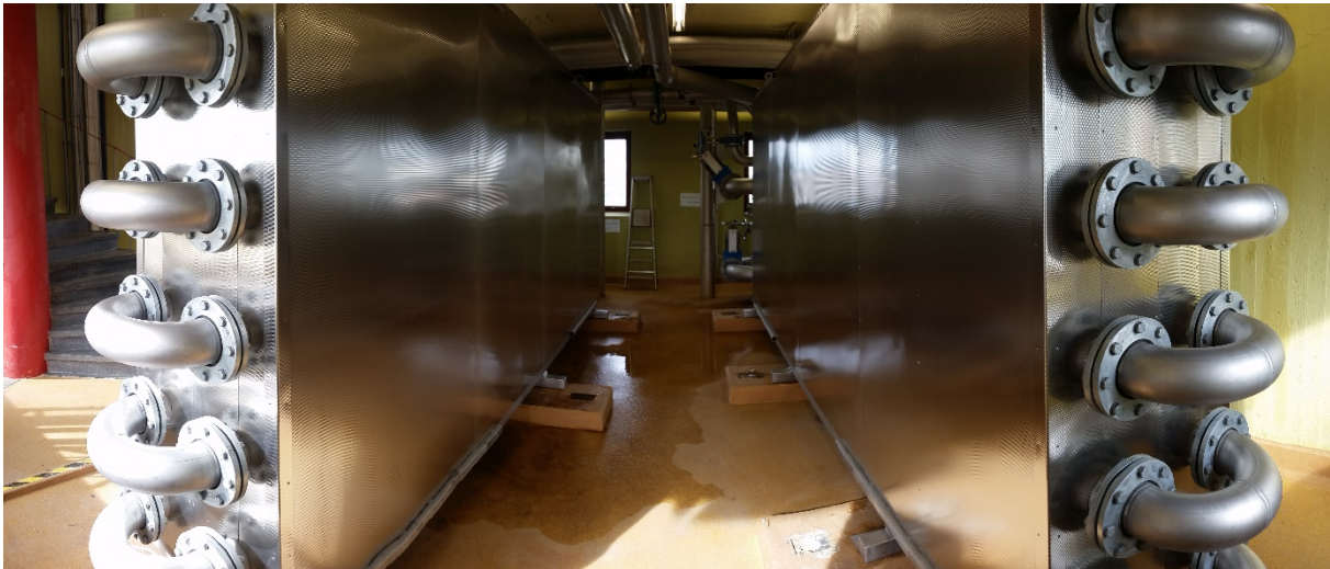
Figur 7. Nya värmeväxlare. Foto: Michael Kämpenberg.
