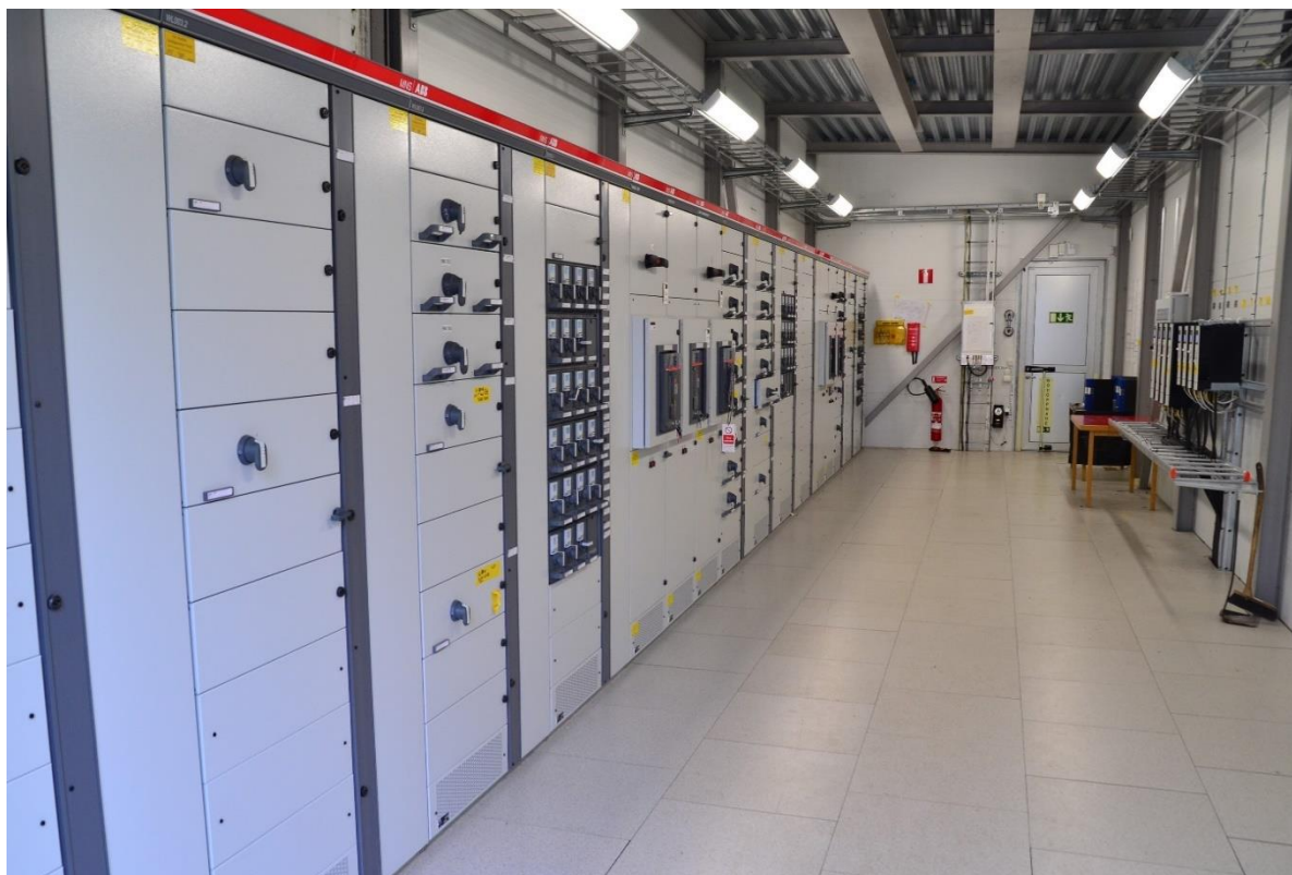
Figur 4. Nya ställverket. Foto: Michael Kämpenber.
