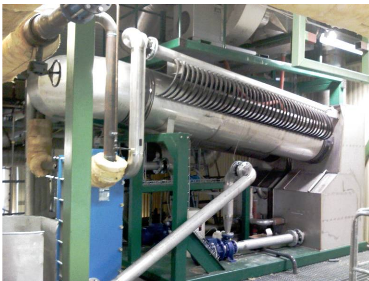
Rökgaskondenseringen till Panna 3
