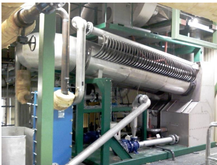
Figur 4 Rökgaskondenseringen vid Panna 3
