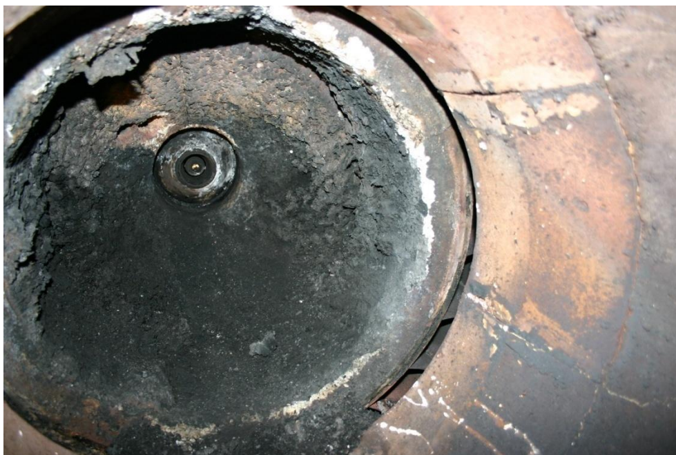
Figur 5 Brännare inifrån Panna 3, med slaggbildning
