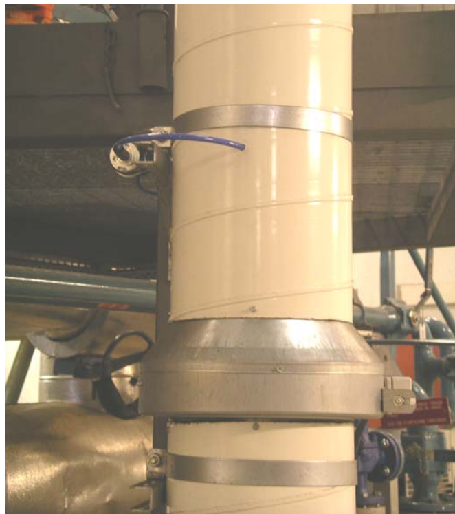
Uttag till mätinstrument för freon i ventilationskanal
