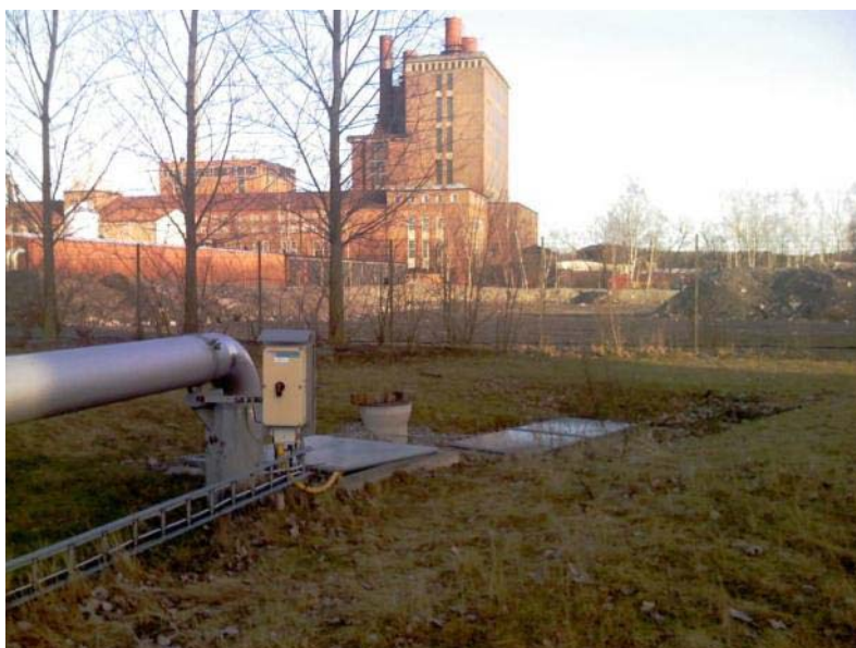
Figur 5 Kylvattenledningens inlopp och pumpgröp till Värmepumpverket
