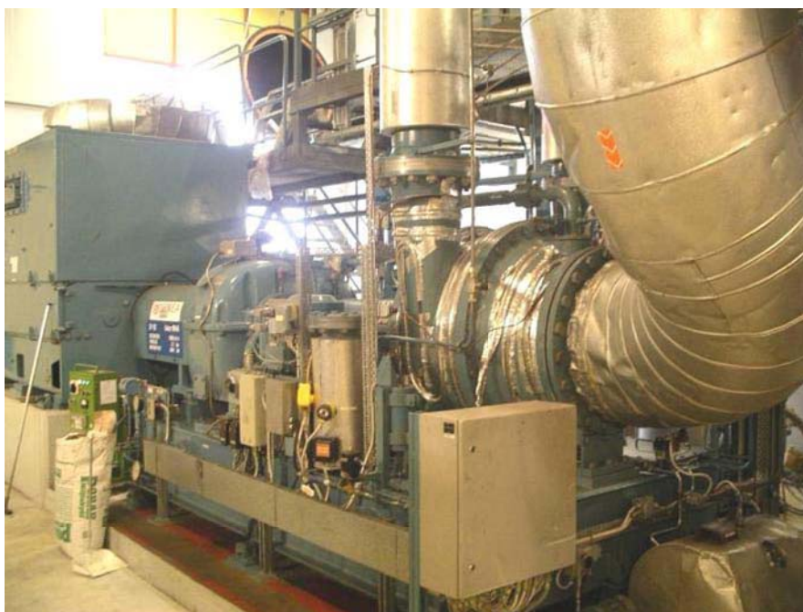
Figur 1 Elmotor och kompressor på Värmepump 2
