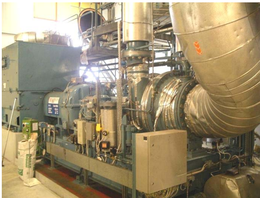
Figur 2 Elmotor och kompressor på Värmepump 2
