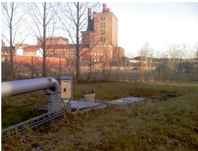
Figur 7 Kylvattenledningens inlopp och pumpgrop till Värmepumpverket
