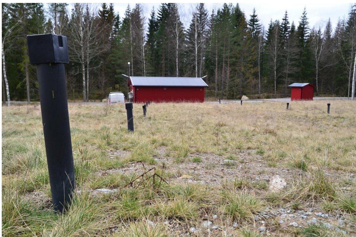
Figur 5. Luftningsrör i markbädd. Foto: Michael Kämpenber.
