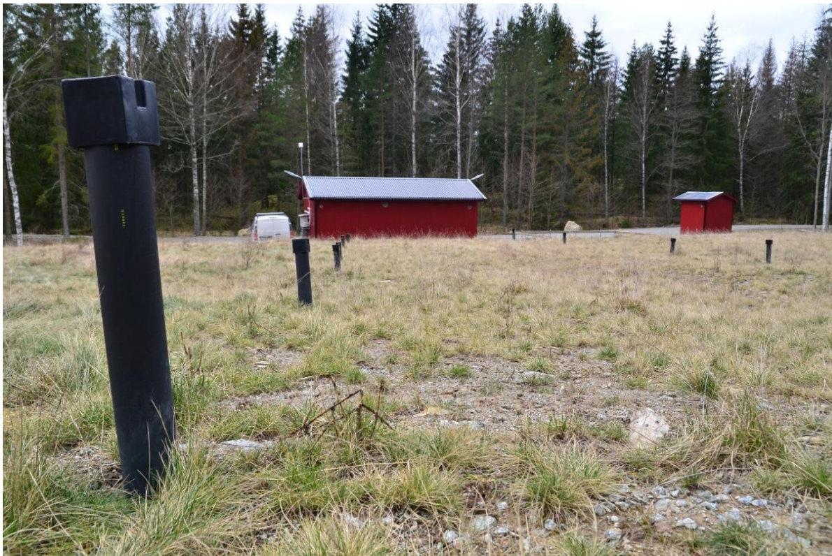
Figur 4.2. Luftningsrör i markbädd. Foto: Michael Kämpenberg.
