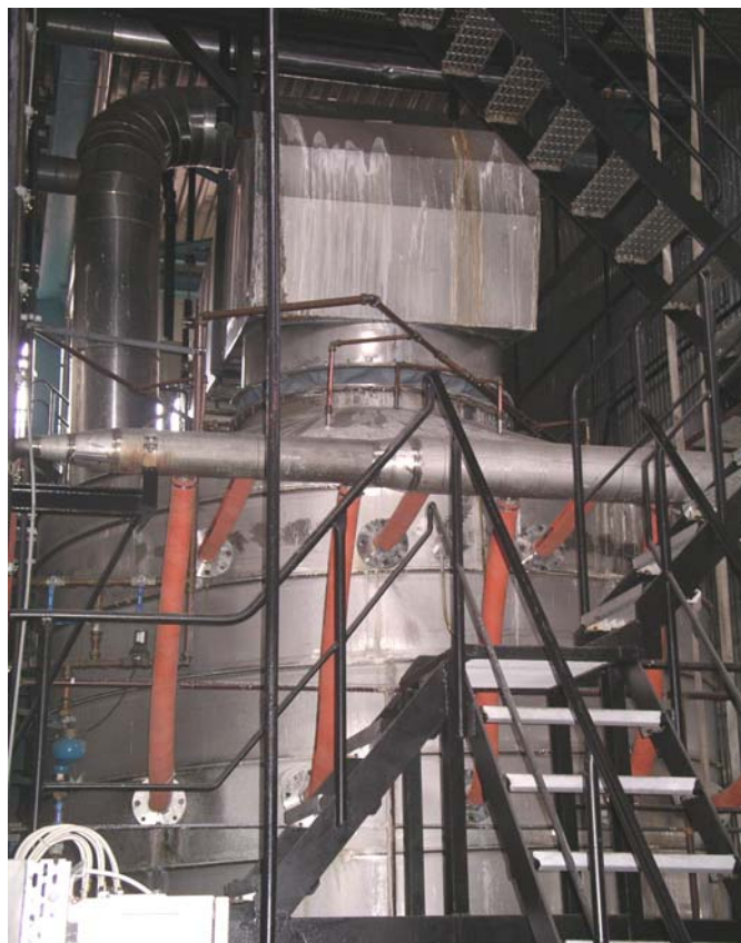
Toppen på skrubbern med inlopp för dysvatten
