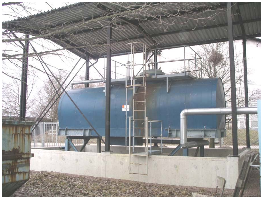
Luttank med invallning och nederbördsskydd
