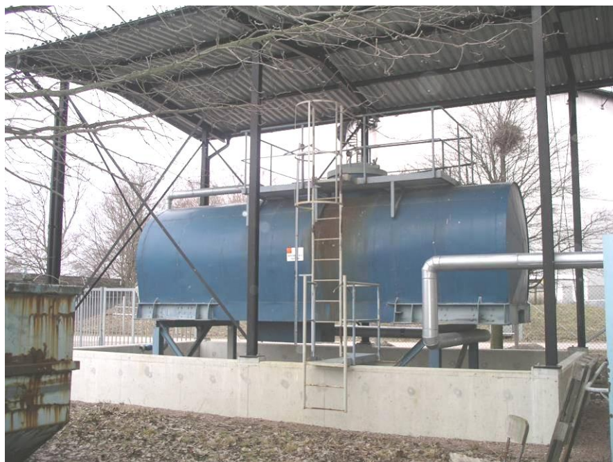
Figur 3 Luttank med invallning och nederbördsskydd
