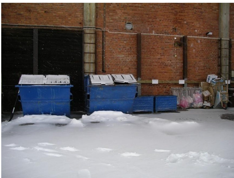
Figur 5 Station för källsortering. På bilden har snå blåst in under tak p g a kraftig vind
