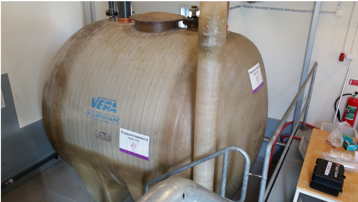
Figur 5. Polyaluminiumklorid som används som fällningskemikalie förvaras invallad. Foto: Peter Forsstedt.
