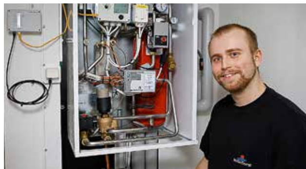
Dagens fjärrvärmeväxlare är moderna och tar väldigt liten plats.
