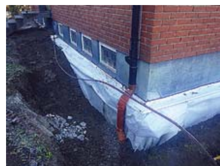
Här håller man på att återfylla. En markduk är uppsatt runt dräneringen, isoleringen och det grova gruset.
