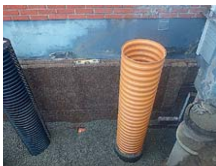
Nu finns tre brunnar på tomten. Den svarta är en dräneringsbrunn som pumpar dräneringsvattnet till dagvattenbrunnen. Den bruna är en spolbrunn med bakvattenskydd i spillvattenservisen. Den gamla betongbrunnen är dagvattenbrunnen som tar emot dräneringsvattnet och takvatten från stuprören.
