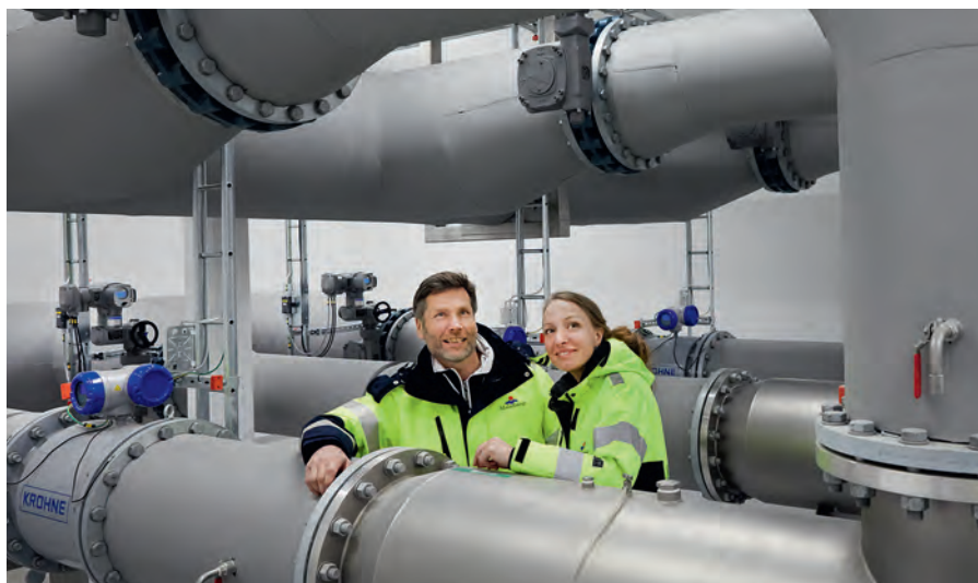
Börje Gestlöf och Charlotta Magnergård vid den nya UV-ljusanläggningen på Hässlö vattenverk.
