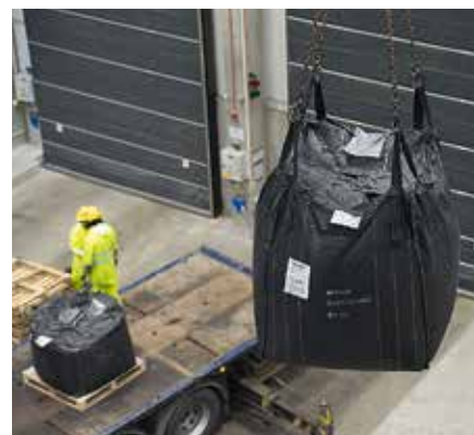
Stora mängder aktivt kol har bytts ut i kolfiltren. Det fångar upp lukt i bränslebyggnaden och i ballagret.
